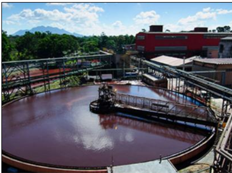
Figura 2-4 – Espessador para o desaguamento e espessamento de rejeitos.
