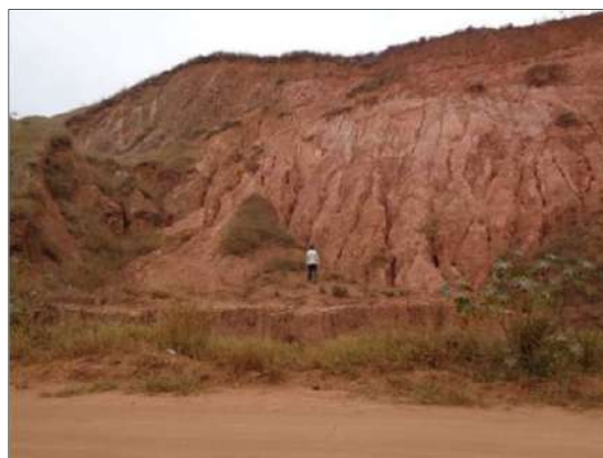
Fotos 4.1.6-8 - Sulcos erosivos identificados taludes expostos (778201E/ 7704491N)
