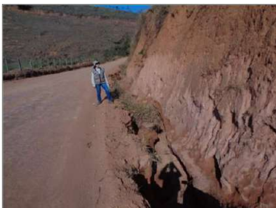
Fotos 4.1.6-7 - Sulcos erosivos identificados às margens de estradas vicinais na área de estudo (Coordenadas: 779604E/ 7705047N)
