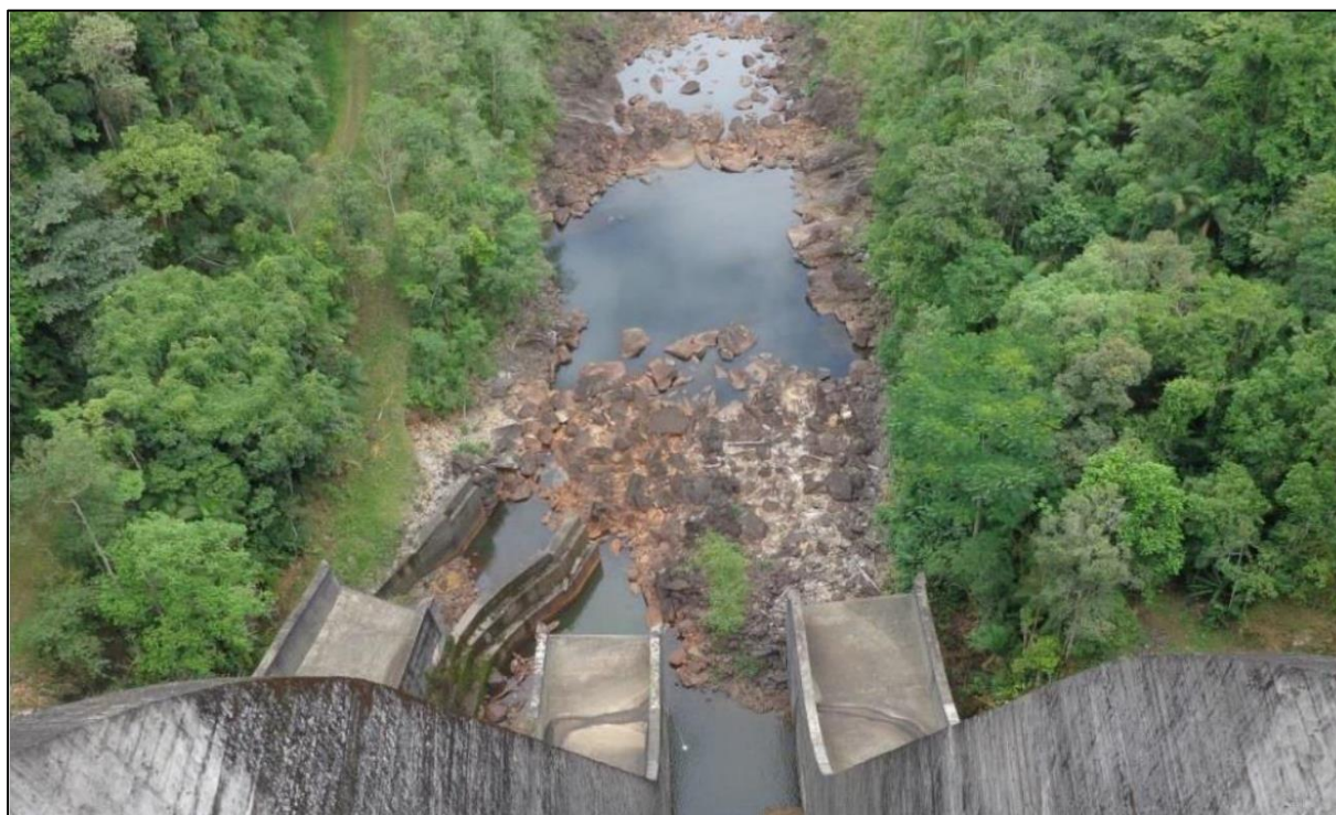
Figura 10. Bacia de Dissipação - UHE Barra.
