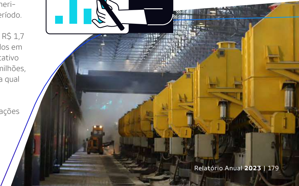
Sala Fornos 3, Fábrica Alumínio (SP)
